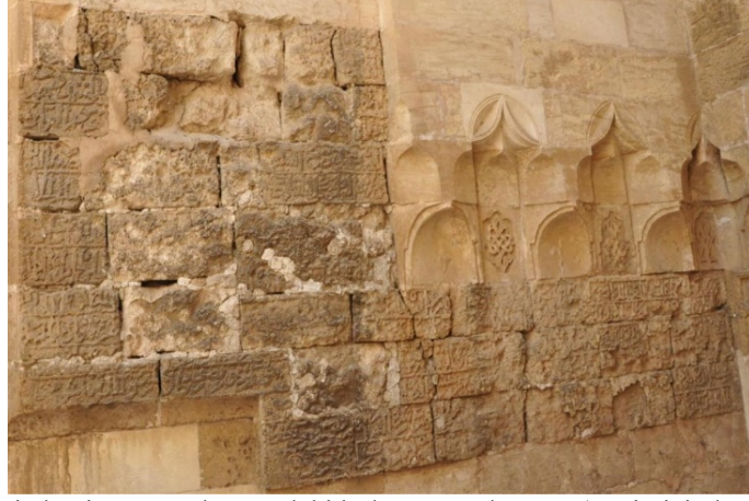
Kitabenin güney duvarındaki bölümünün durumu (metin içinde C)
